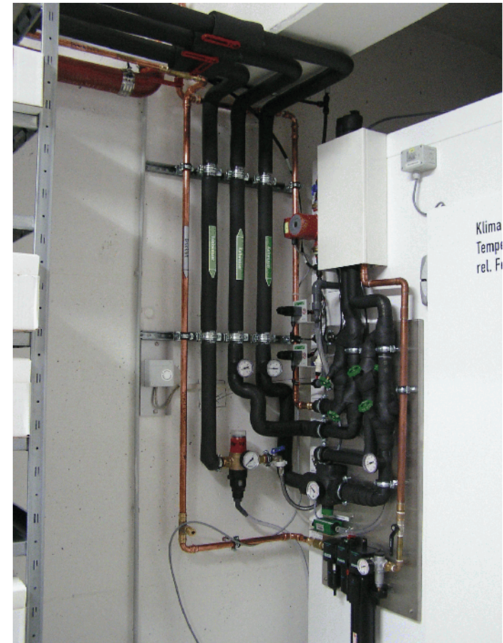
Bild 17: Notkühlung mit Wasser
